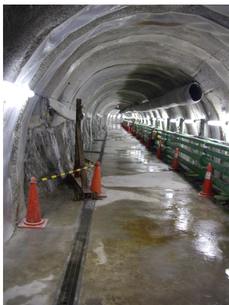
圖十八 坑道內地下水甚多
