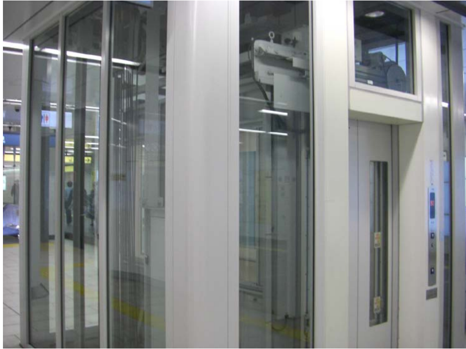
電梯採有可透視之玻璃設計，以增加安全性
