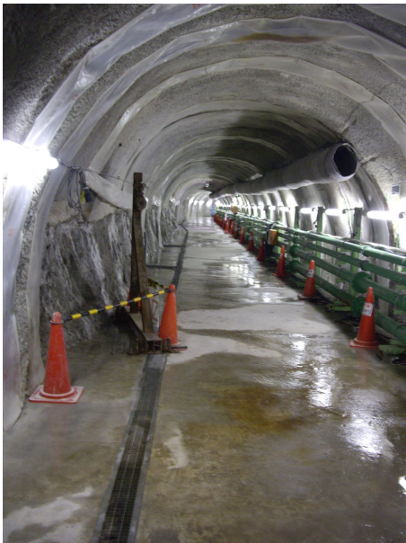
圖十八 坑道內地下水甚多
