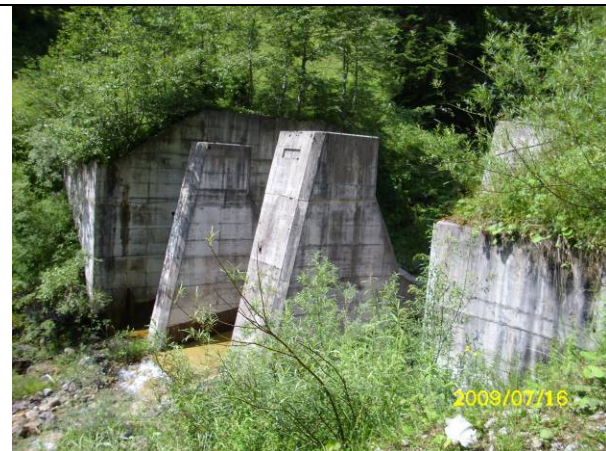
照片 15 Karbach 防砂壩
