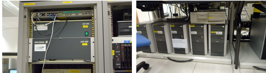
圖三：左為ERICSSON ROUTER，右為COMSOFT ROUTER
