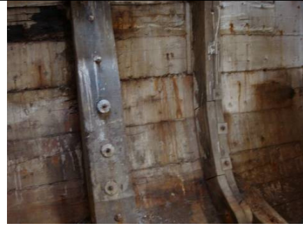
圖二十二、部分結構以金屬釘補強
