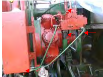
管路回裝完成、試運轉漏油處
