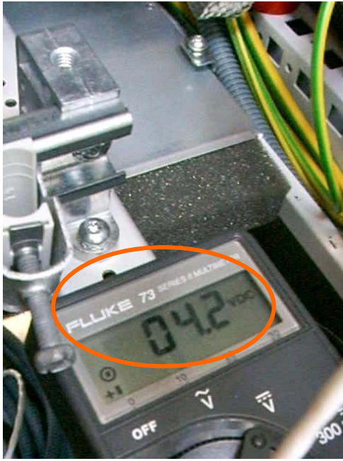
圖二十 一般量測電錶呈現狀況
