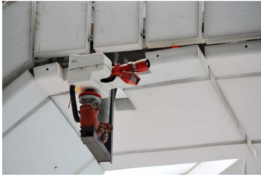
圖 10 紅外線偵測定位與自動消防水砲
