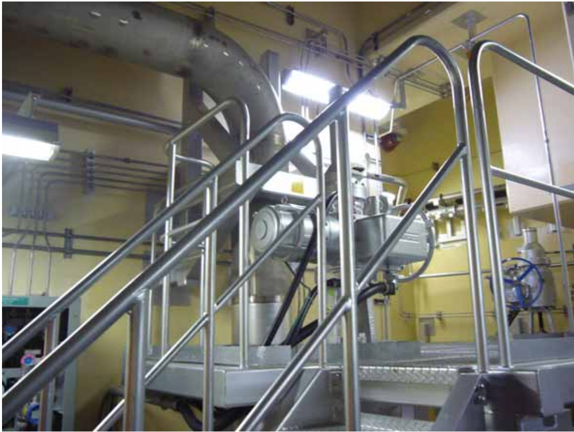
圖一：新增之管路支撐器(以黃色符號貼示)
