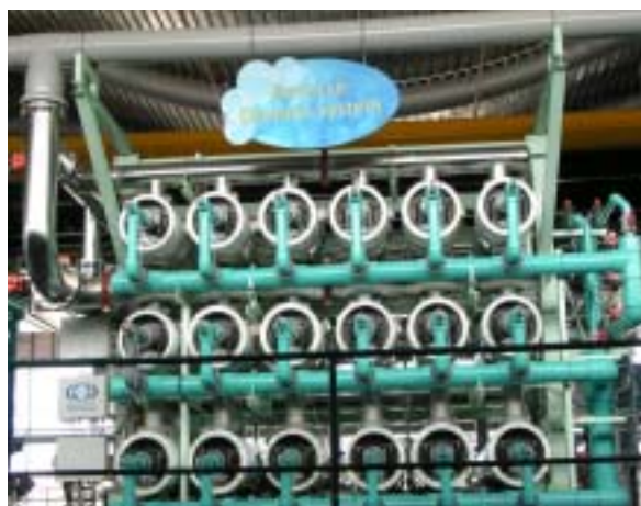
過濾廢水設備
