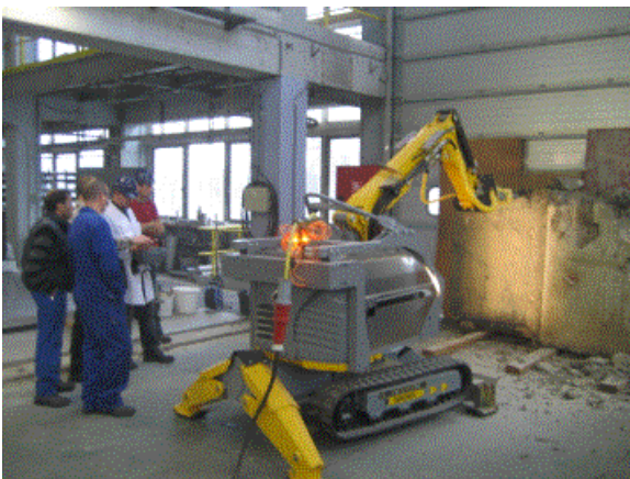
圖 12. 比利時 BR3 高污染遙控除污設備
