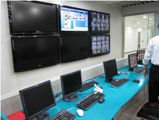
圖 16 北京國家圖書館電腦機房中控室
