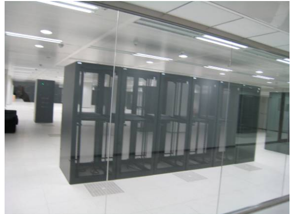
圖 17 北京國家圖書館電腦機房之一
