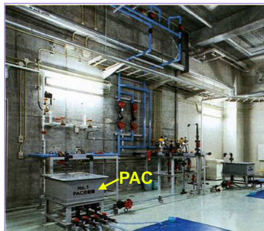
PAC注入設備
