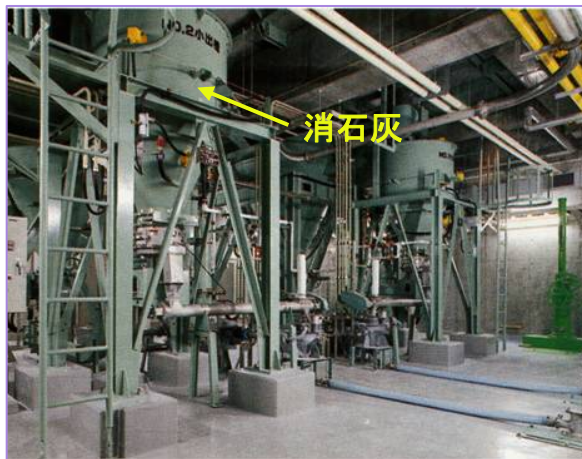
消石灰注入設備
