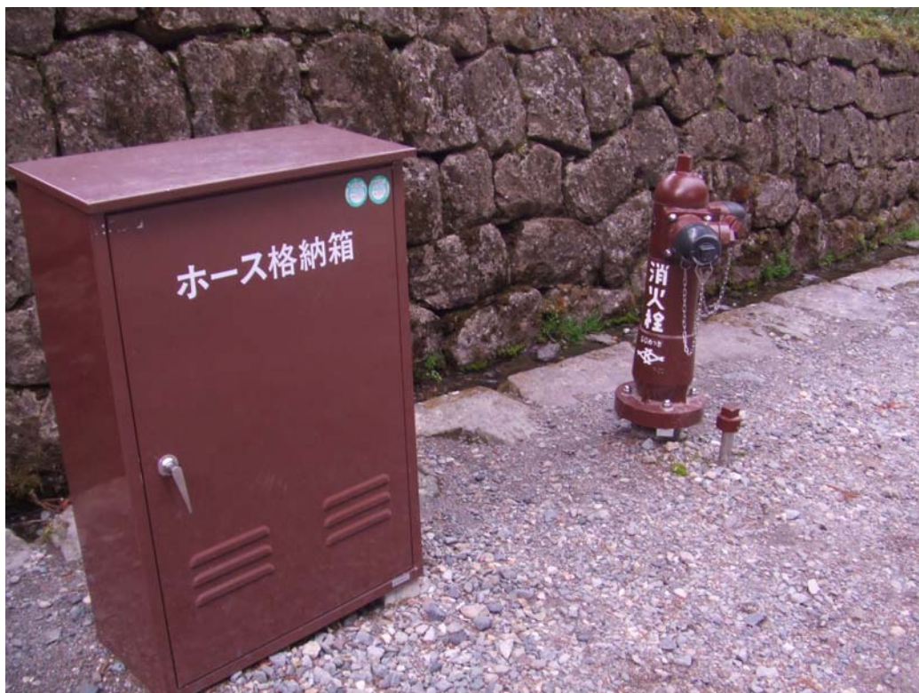
相片 21：東照宮室外消防栓
