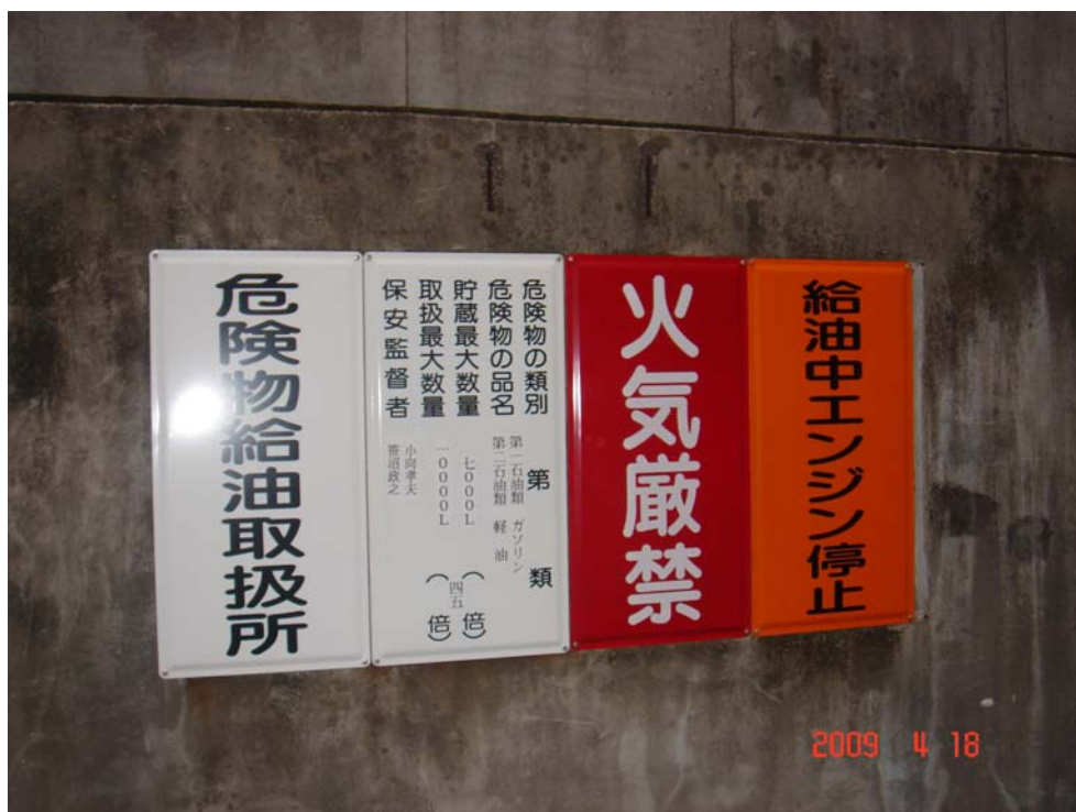
相片 29：本郷消防署加油站危険物品標示牌
