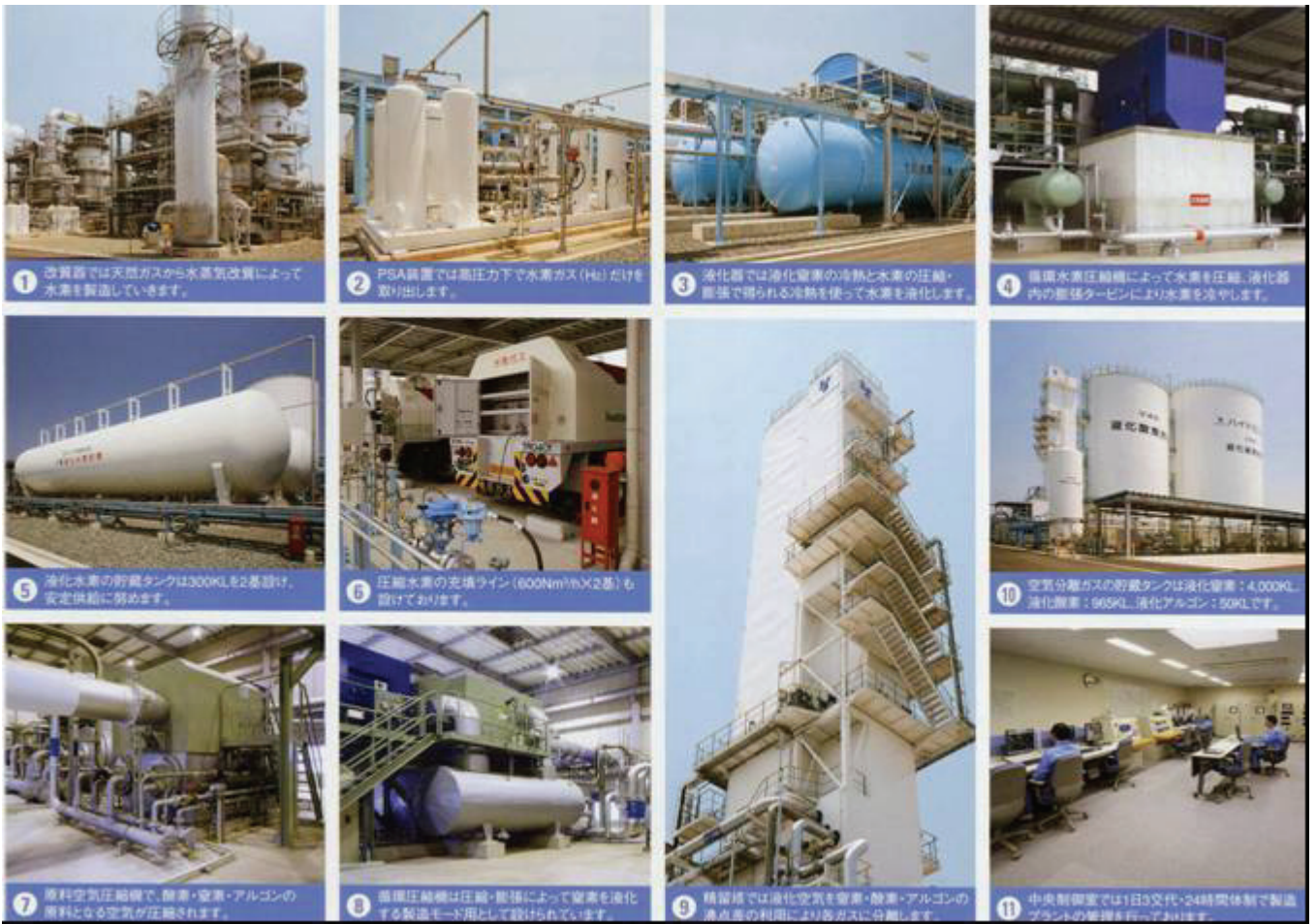
圖 5 HYDRO EDGE 公司之氣體生產製程設備
