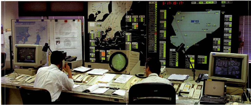
圖 3.2.4 東京羽田機場助導航設備監控中心
