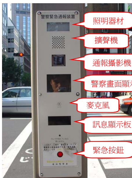
相片 4：緊急通報設備各部器材
