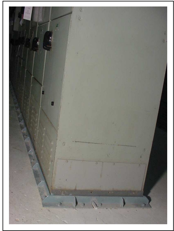
馬達控制中心利用錨栓固定
