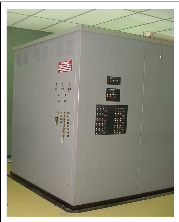
控制室盤面利用錨栓固定
