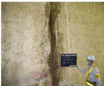
海水排水渠道內部接合處發生裂縫
