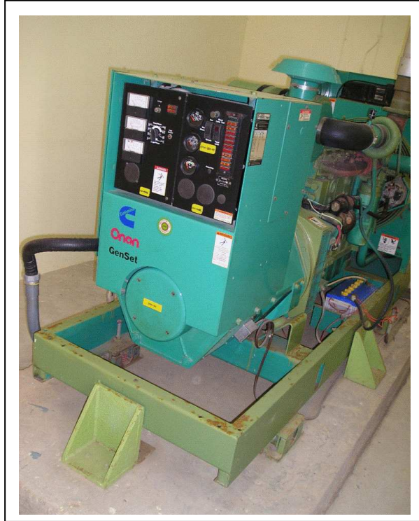
EFM 系統柴油發電機加裝地震限制器 (SEISMIC RESTRAINTS)
