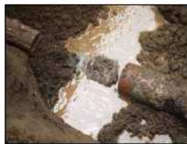
消防系統地下埋管受損
