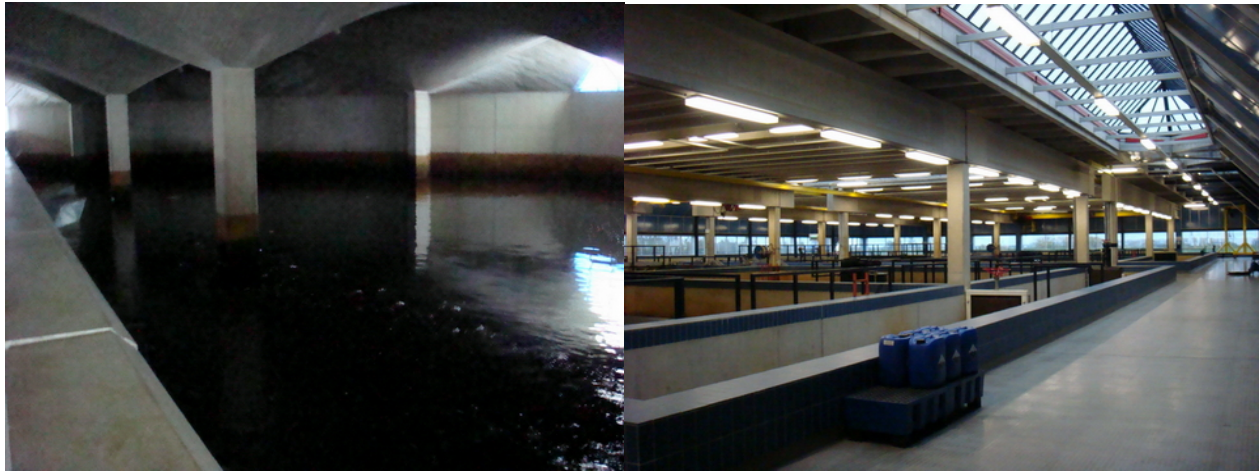
相片 2.3.8-7 PWN 水公司位於室內的淨水設施，左側為處理後之清水儲水槽
