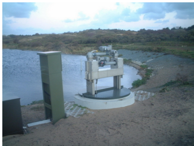
相片 2.3.9-12 作為備用水源之深井抽水系統(所抽之水直接放入渠道再流到抽水站)
