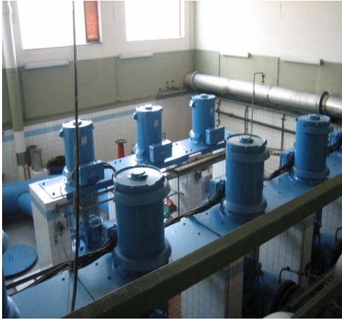
圖 2.28 污水與雨水抽水站
