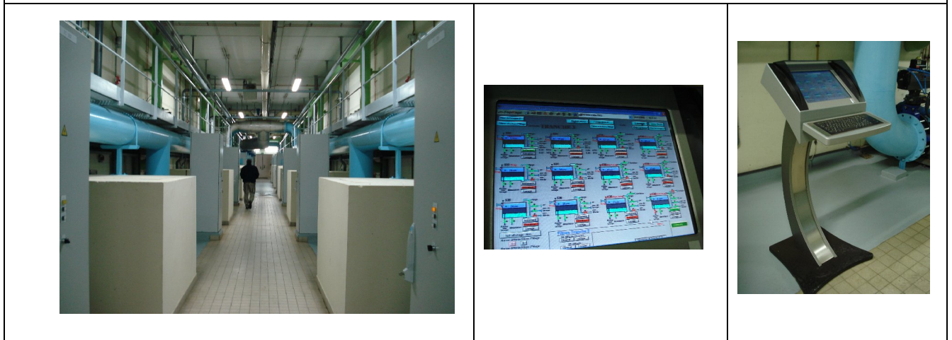
圖 35 Morsang-sur-Seine 高級淨水處理場三期快濾池地下水管廊及操作監視機台
