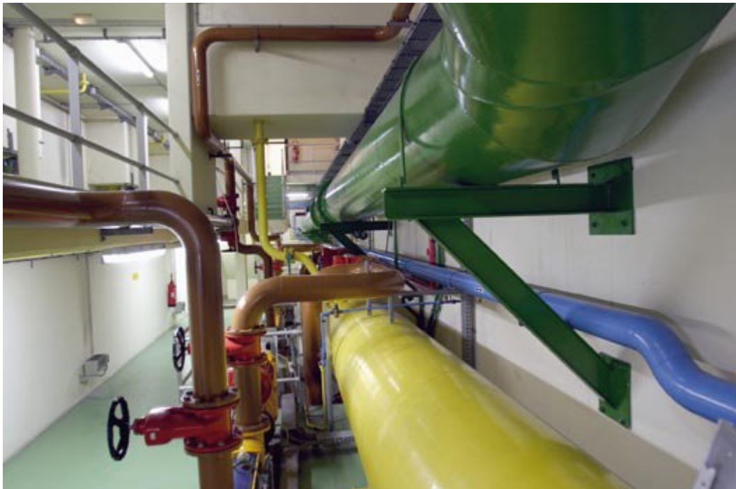
圖 40 (10) Mont-Valerien 高級淨水處理場實施顏色管理標示每一種管線用途
