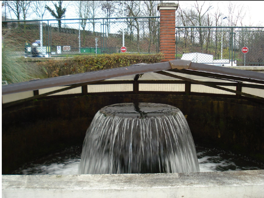
圖 40 (2) Mont-Valerien 高級淨水處理場原水分水井
