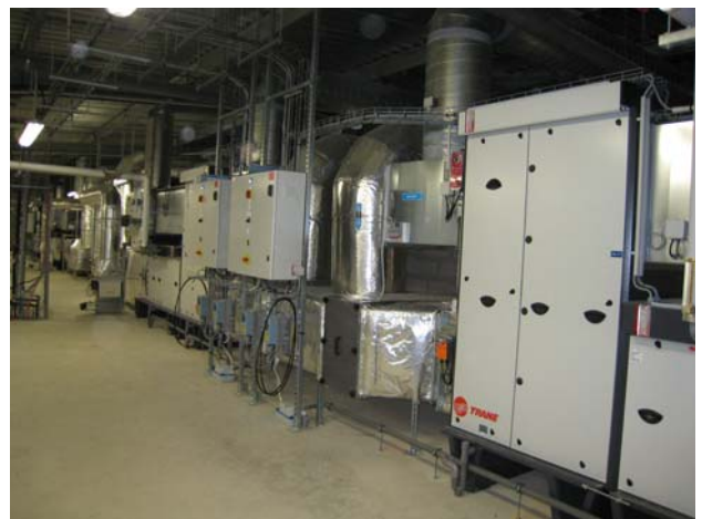
圖22、INPREST2樓為中央過濾空調、不斷電 系統區域
