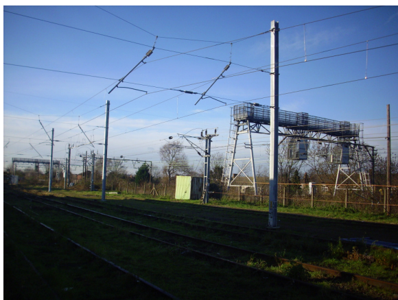
照片 3 電車線訓練場地
