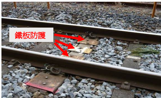
圖21 軌電路電纜線防護
