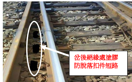
圖 61 岔後絕緣塗膠防脫落扣件短路
