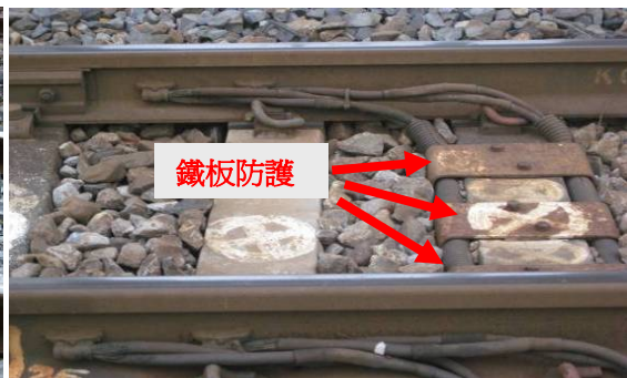
圖22 電力接地線防護
