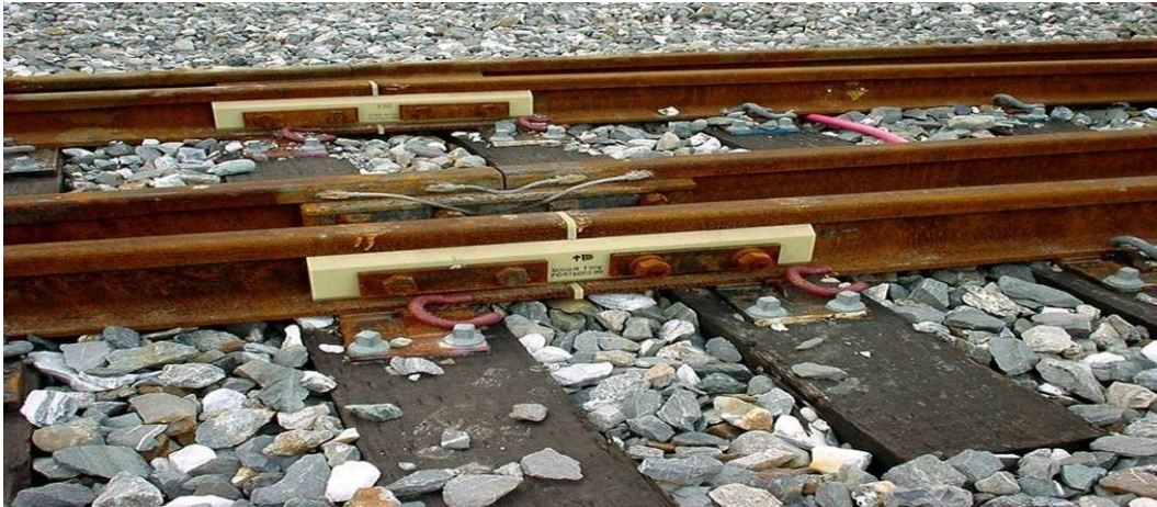
圖47 台鐵站場拍攝之軌道電路實體圖
