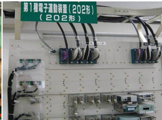
圖35 測試完成的電子聯鎖裝置
