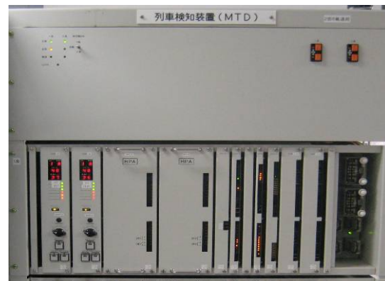
圖37 測試中的列車檢知裝置
