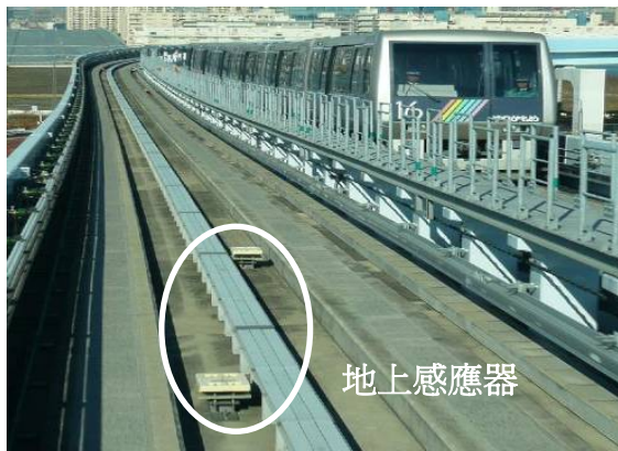
圖3 少量道旁號誌設備
