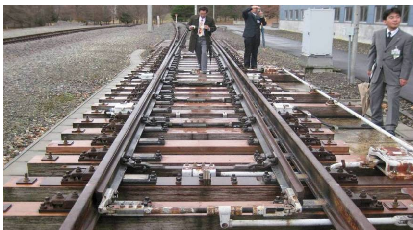
圖13 電動轉轍器就地現場扳轉情況
