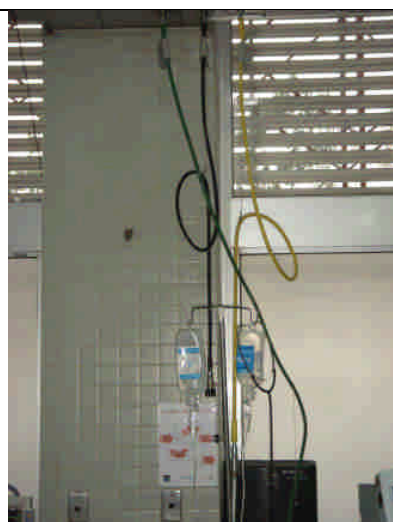
ICU 由天而降的管道設備
