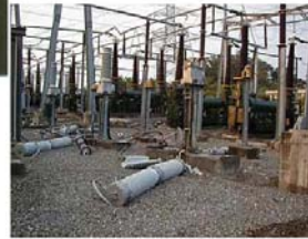
開閉機器の損壞
