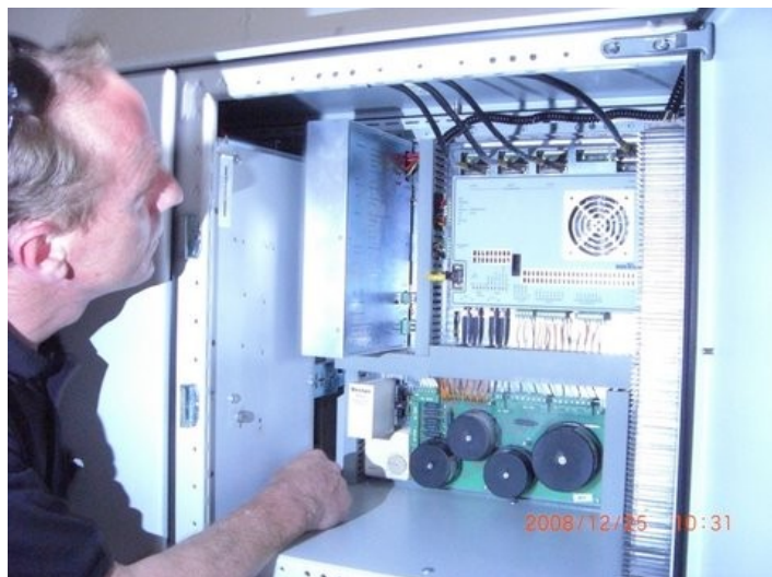
圖 3-16：控制器機櫃內部
