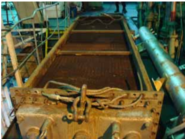
M/E AIR COOLER
