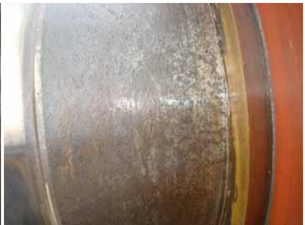
Chain drum 軸之表面有輕微之腐蝕
