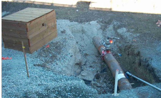
廠區一條地下汽油管線 Line 63 破漏
