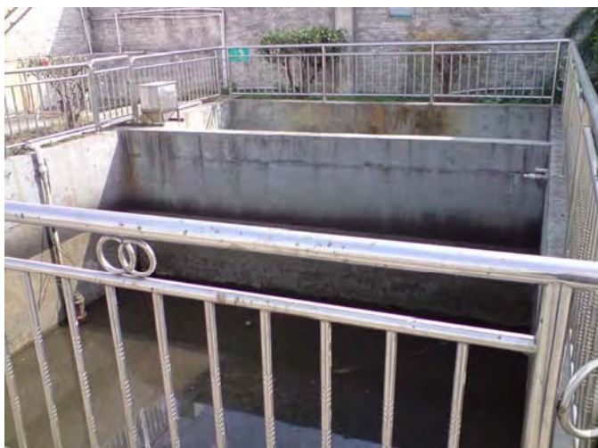
照片 55 肇慶市佳華處理廠污水處理設施
