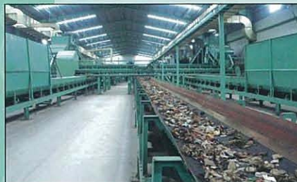
機械自動分選系統 Mechanical Automatic Sorting System
