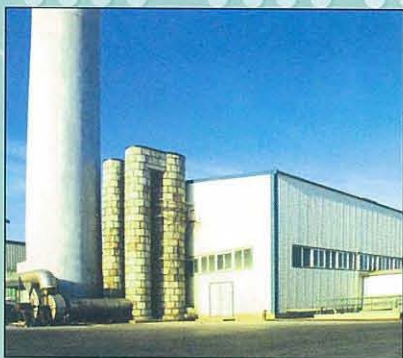
廢氣處理站 Odorous gas treatment system
