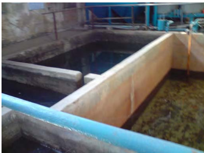
照片 29 廣東金盛富塑料公司之污水處理設施
