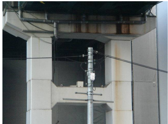
橫交道路自動監測儀器現況
