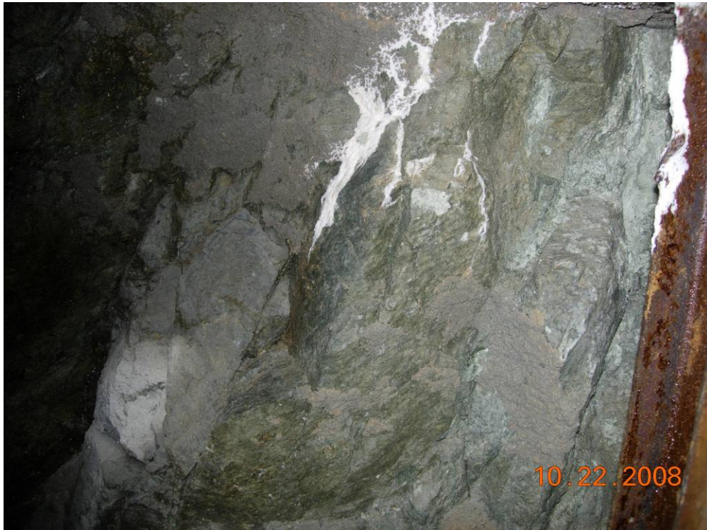
圖 19 東濃地科中心坑道壁(有鈣鹽析出)
