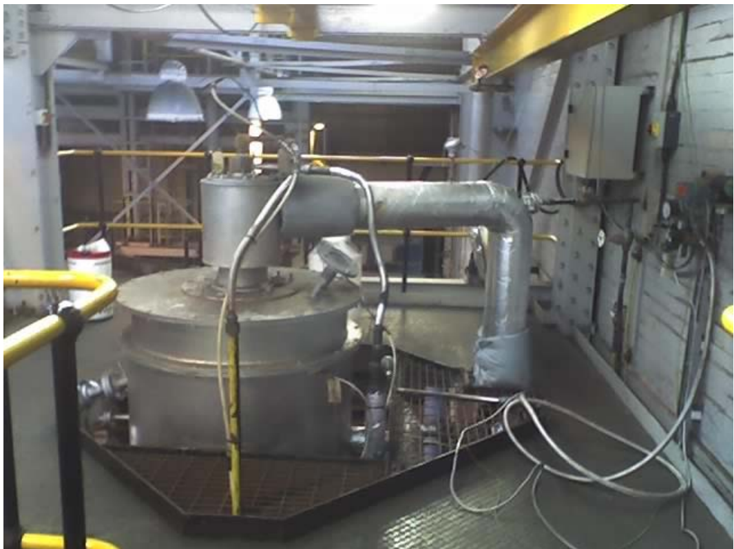
圖 2.1.3-2 燃燒爐頂 Burner 系統
