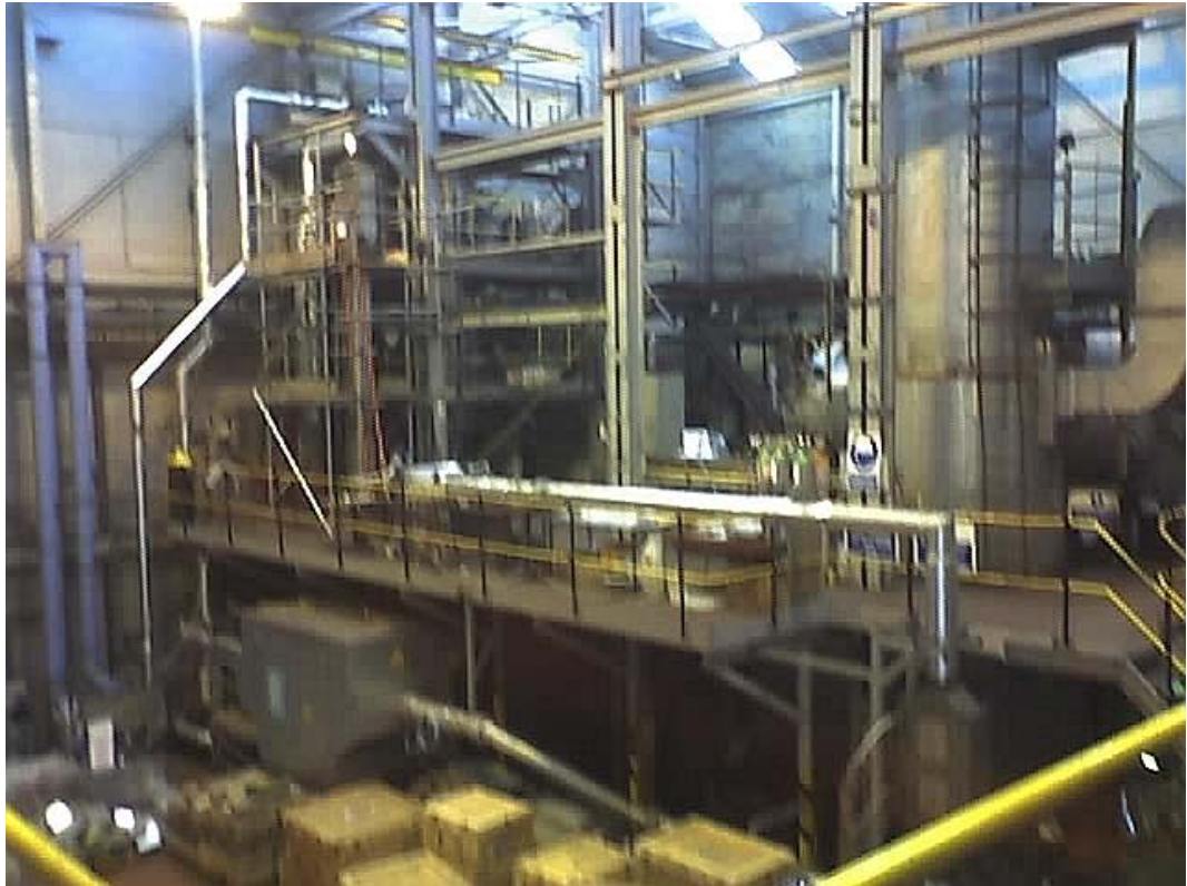
圖 2.1.3-1 160KW 小型燃煤試驗爐全貌
