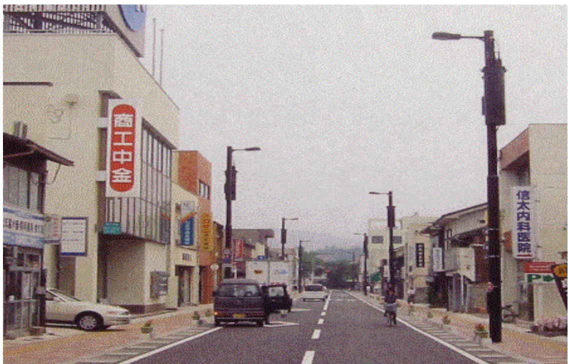
軟性地下化（ソフト地中化）施工後，電桿與路燈桿結合爲一，高低壓電纜皆穿設於鋼管桿內，變壓器(30+50KVA)吊掛於桿上
