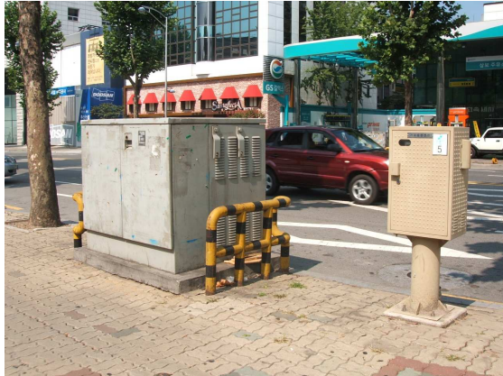
三相 500KVA 變壓器 (寬 ×深×高=170×60×110)
