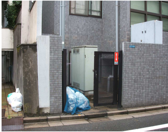
一般高供用戶設置之 地面配電場所
