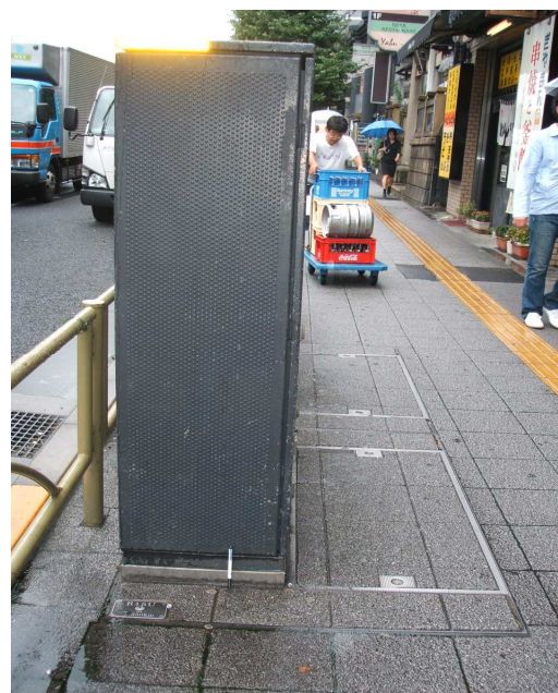
從側面觀察之開關與變壓器 設置於人行道上情形
