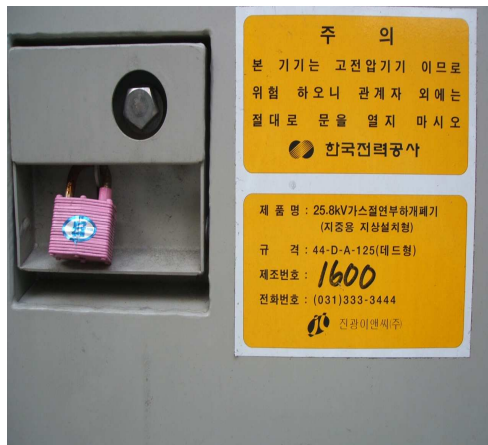
韓國電力公社配電設備
