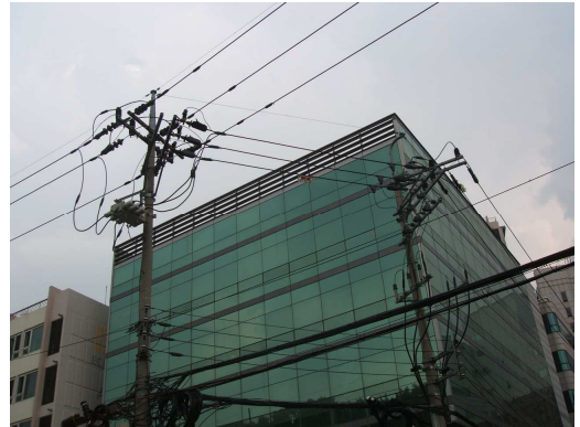
韓國架空配電線路線路 開關及幹線分歧引接裝 置情形
