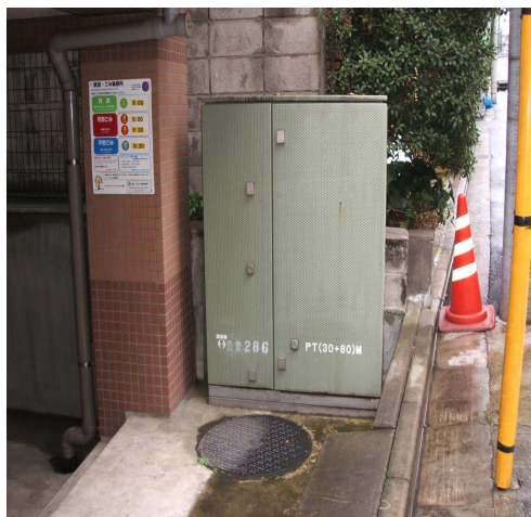
配電設備設置於用戶大門邊
