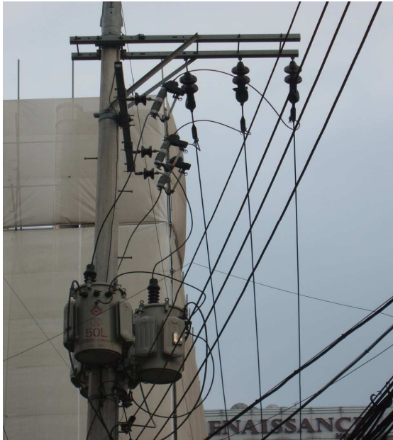
韓國架空配電線路桿上變壓 器裝置情形
