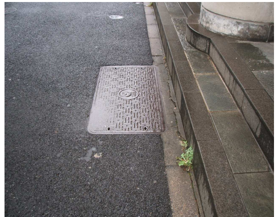
一般孔蓋埋設埋設情形
