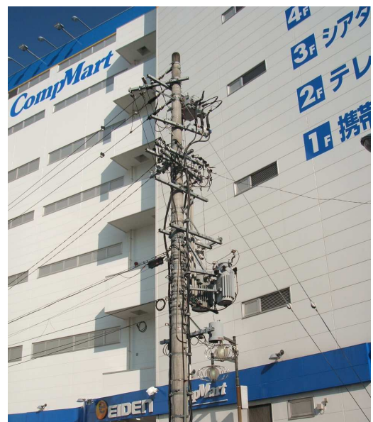
日本架空配電線路複雜 裝桿情形
