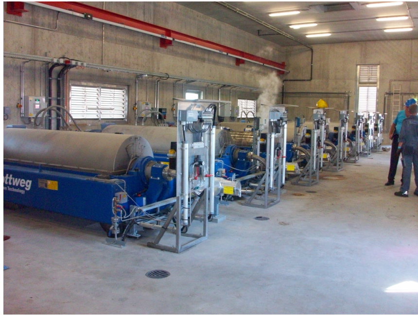
圖十五、Agrana 生質酒精工廠離心操作。其中一部正進行維修，由於是在高溫中操作，拆開之設備可見水蒸氣冒出。
