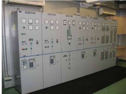
圖六、配電盤模擬設備
