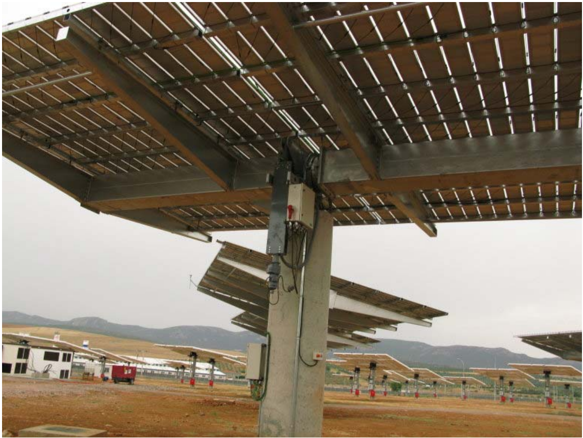
圖 3-10 Isofoton 採用混凝土支柱，控制系統及轉動機構外觀相當單純
