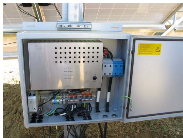
圖 2-37 電子式直流接線箱內部設置
