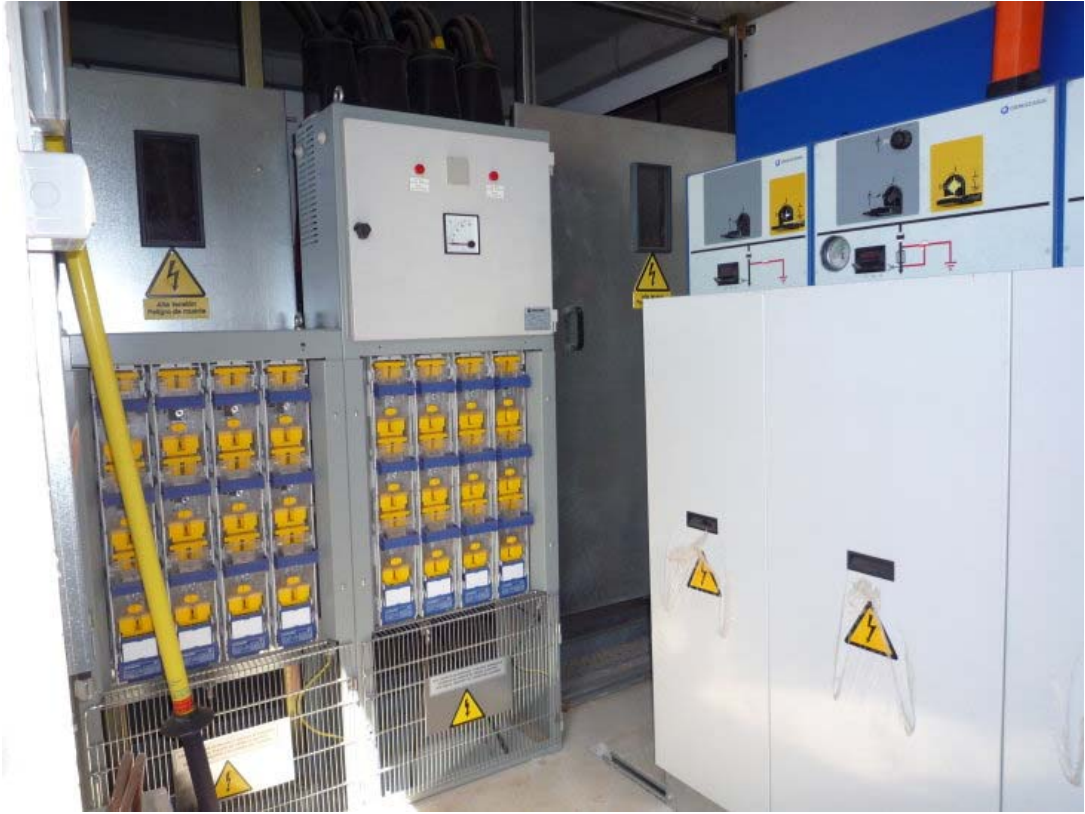
圖 2-20 變壓器室內設備
