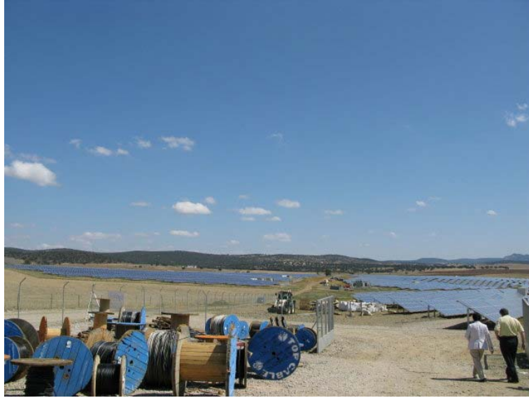
圖 2-47 工地物品放置凌亂，缺乏妥善管理
