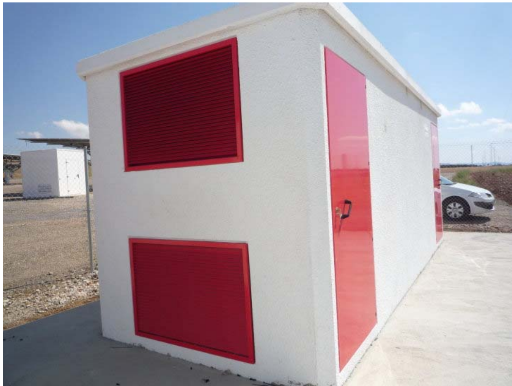
圖 2-23 電錶室採自然通風方式
