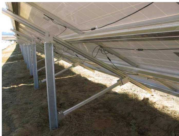
圖 2-43 模組接線未整理隱藏，且未用金屬軟管包覆
