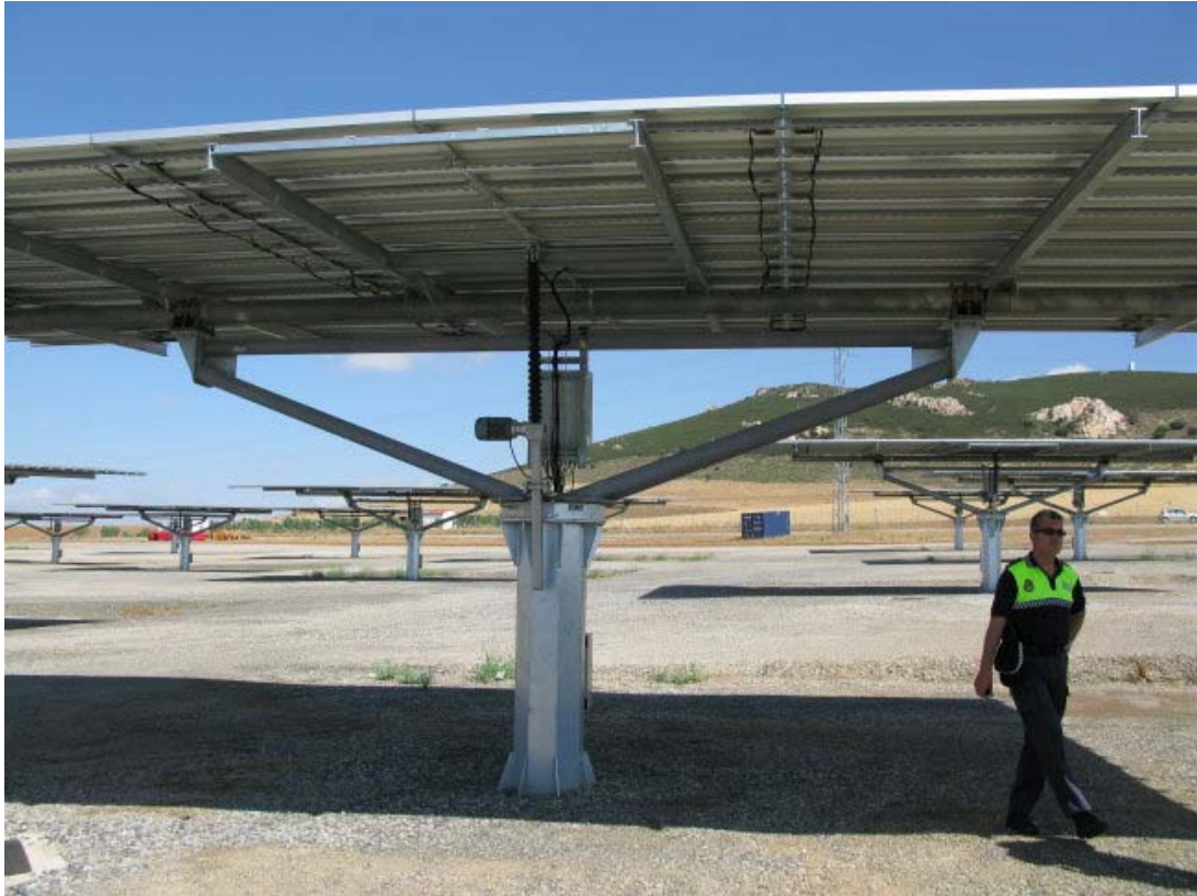
圖 2-4 每支追日式模組機構為 10kWp(1)
