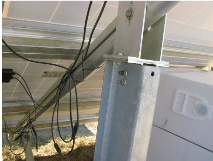
圖 2-44 模組接線凌亂，未整理隱藏
