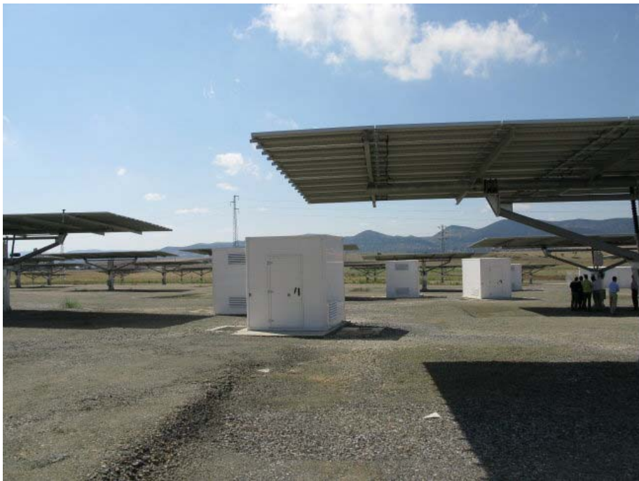
圖 2-13 全部共 31 間電氣室分散設於廠區各位置，每 6 間為一群，較為集中
