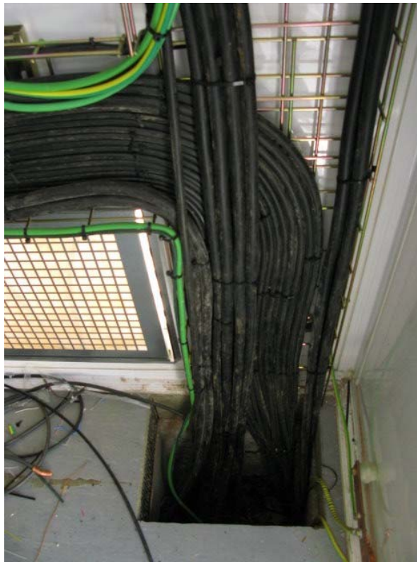
圖 2-15 電氣室內交直流配線地下管道入口
