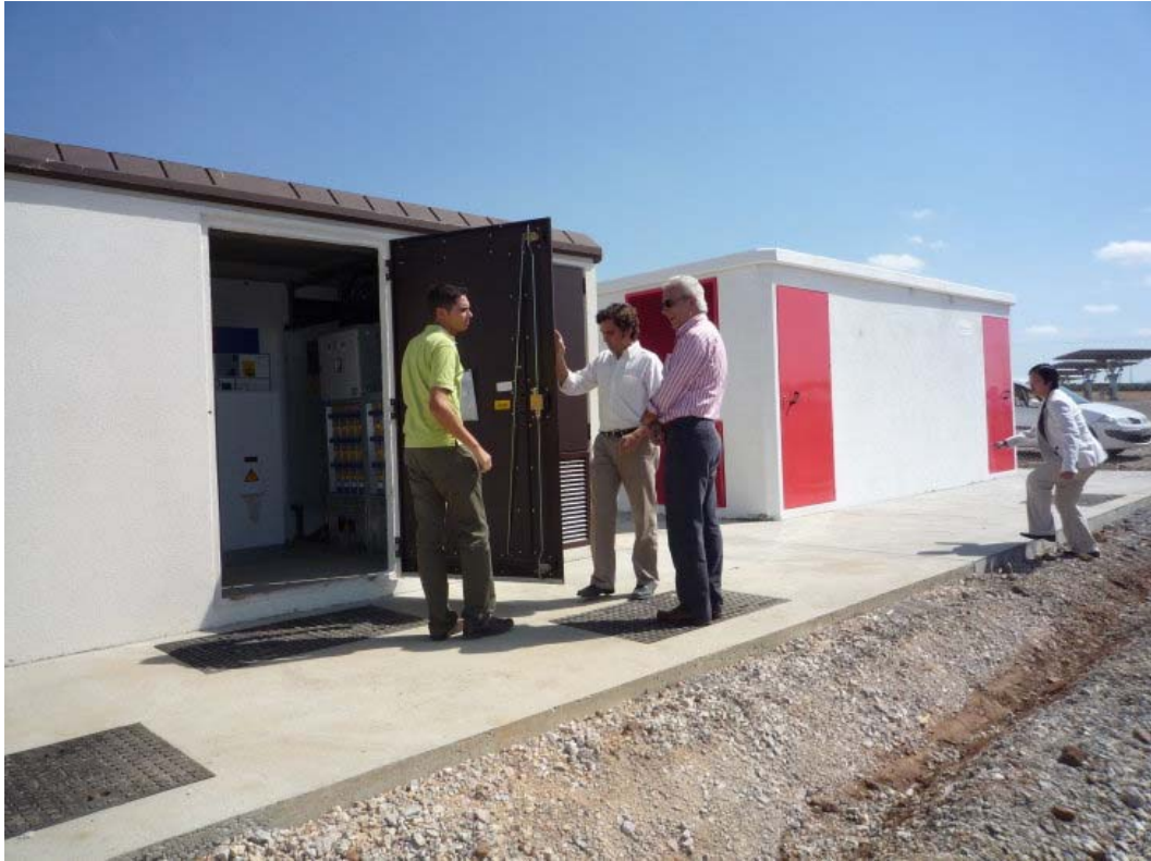
圖 2-26 電錶室及變壓器室設置在同一混凝土基座上，並加以墊高及設置排水孔
