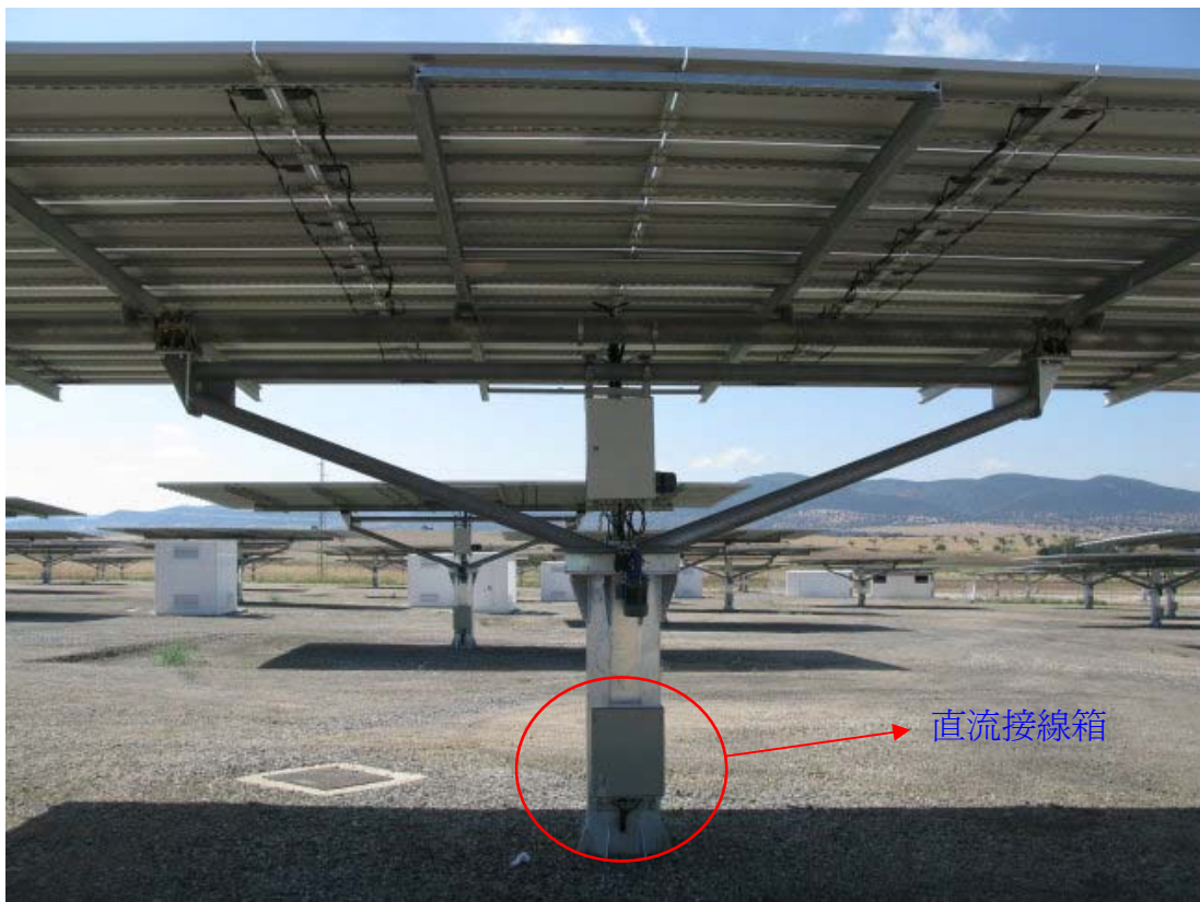
圖 2-5 每支追日式模組機構為 10kWp(2)
