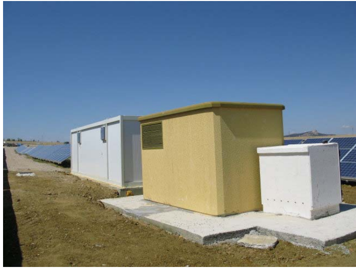
圖 2-32 電力調節器及變壓器室
