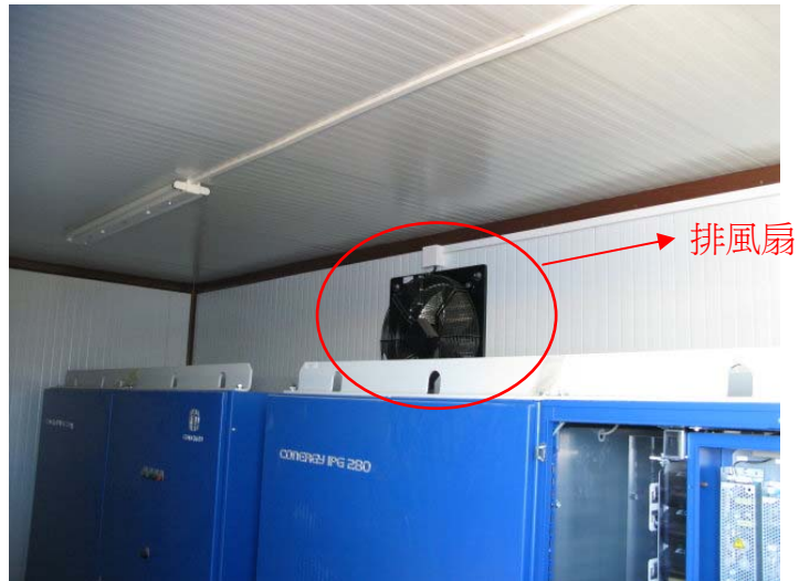
圖 2-33 電力調節器及變壓器室內除自然通風外另設有排風扇
