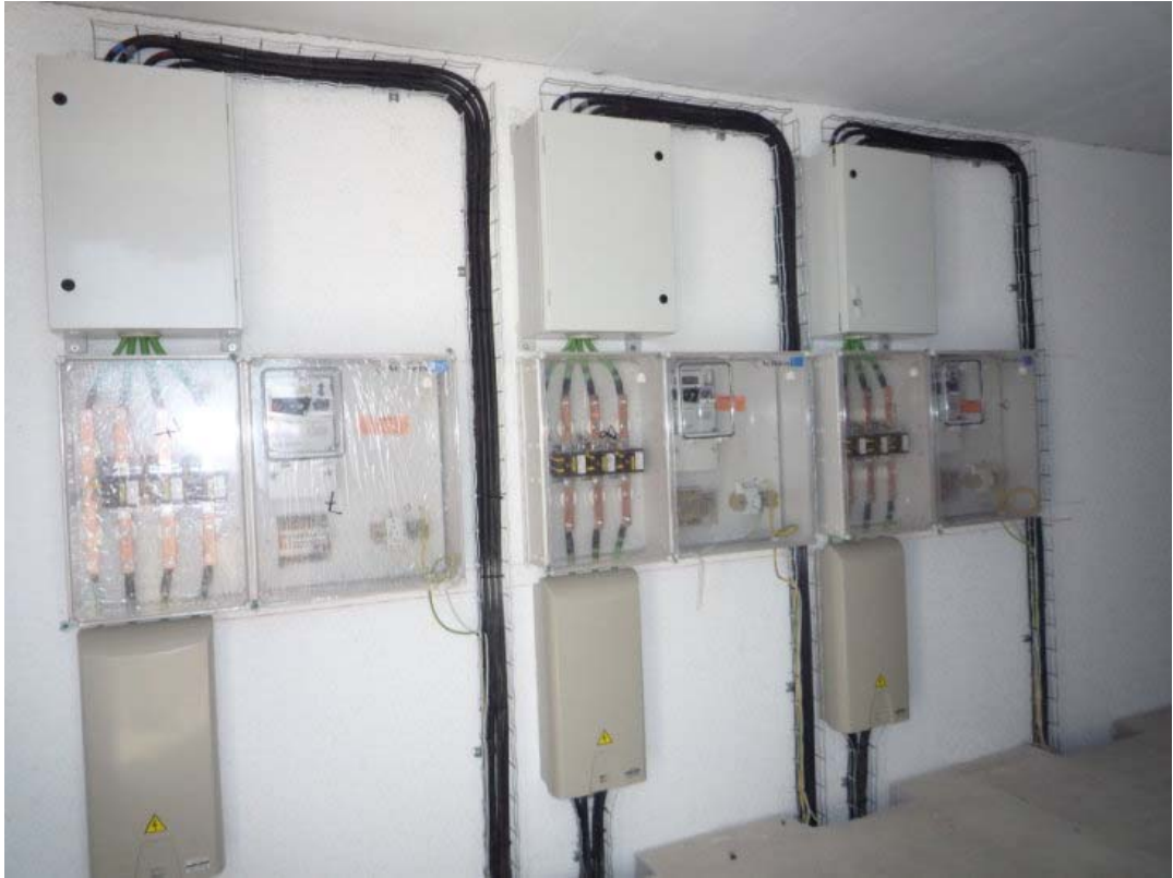
圖 2-18 電錶室內左側 3 個電錶(每間共 6 個)
