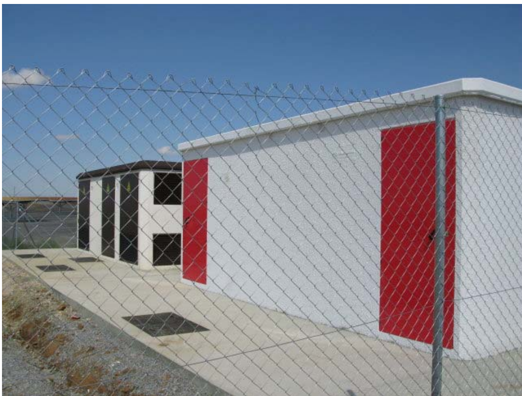
圖 2-16 電錶室(右-紅色)與變壓器室(左-咖啡色)外觀
