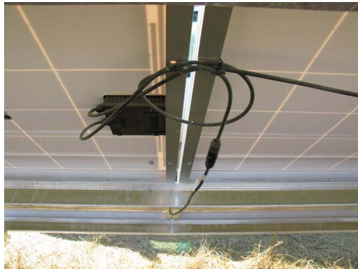
圖 2-42 本工程缺失部分—模組接線未用金屬軟管包覆
