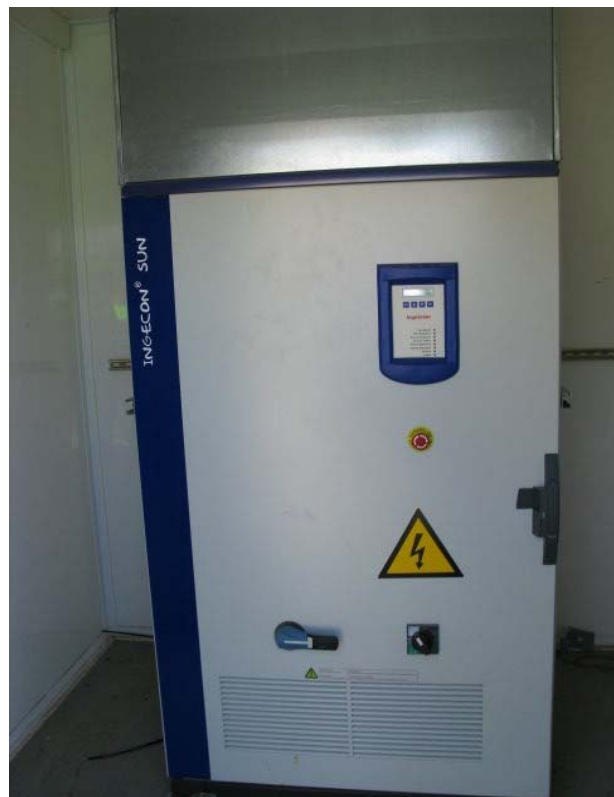
圖 2-11 100kW 電力調節器外觀(西班牙 Ingeteame 公司製造)
