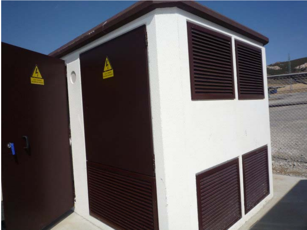
圖 2-24 變壓器室採自然通風散熱方式
