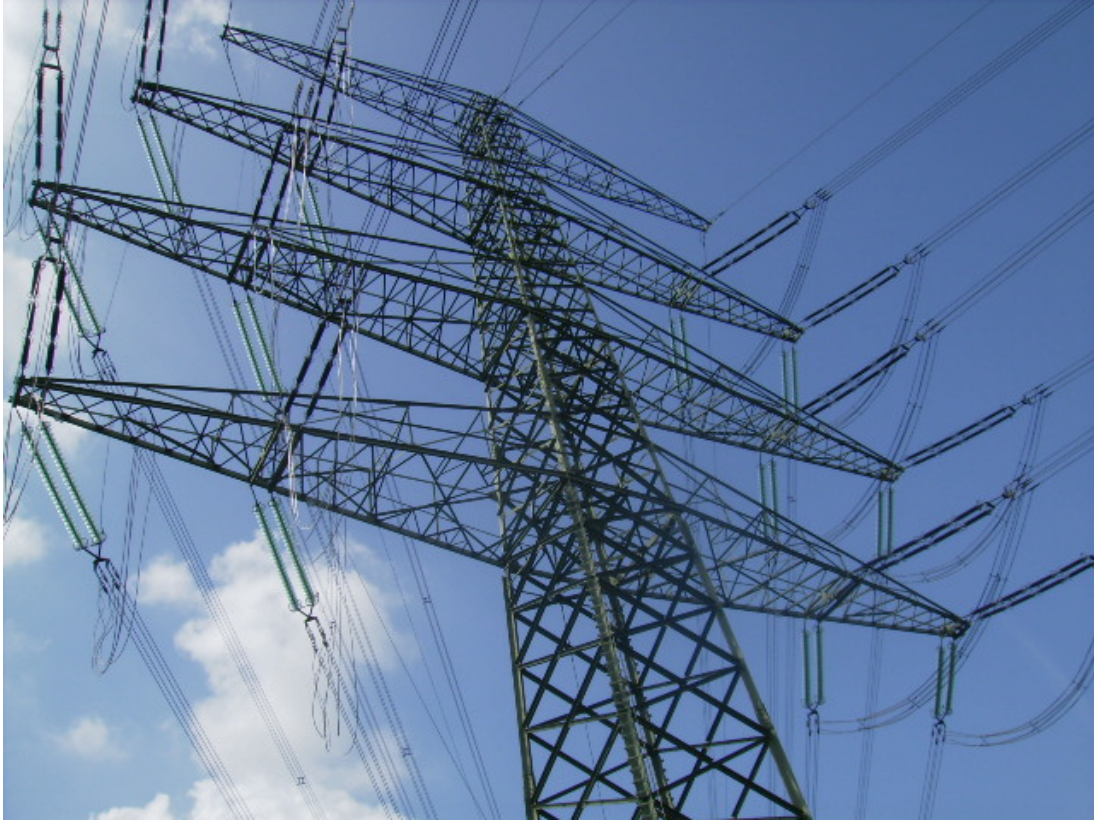
圖 2.5 輸電線路鐵塔上的礙子連
