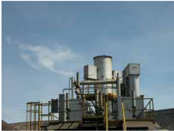
生質能源設施
