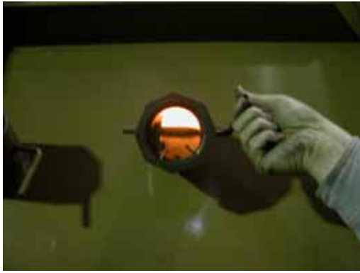
燃燒室－燃燒觀察口
