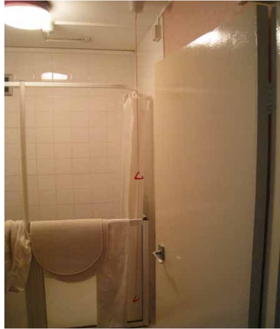
圖 23、浴室緊急呼叫拉繩
