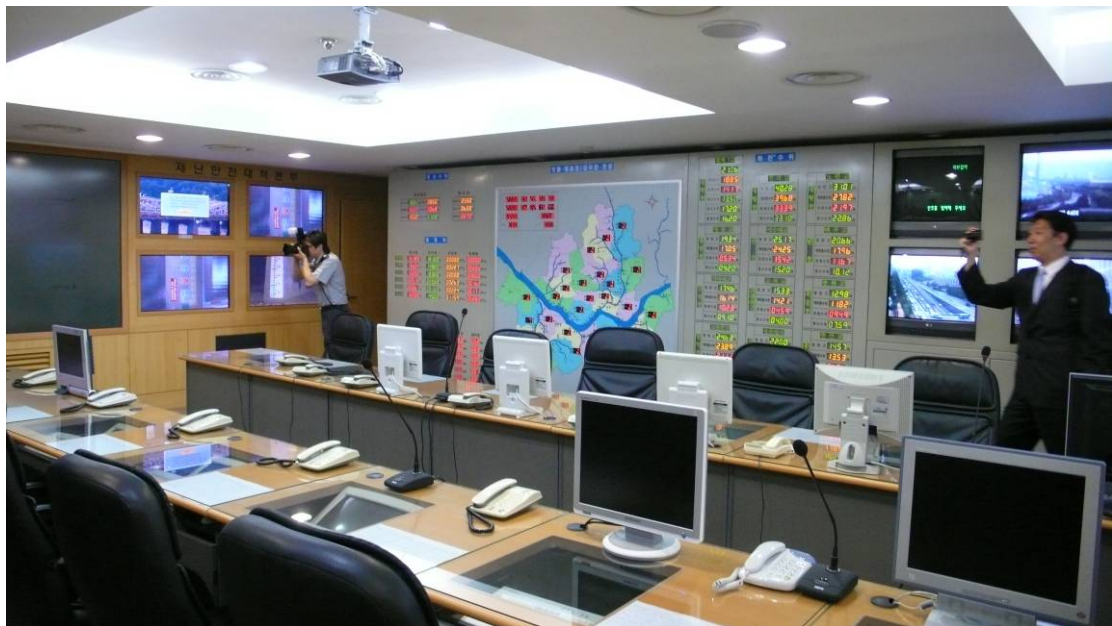
戰情指揮室內即時監測水位及影像系統
