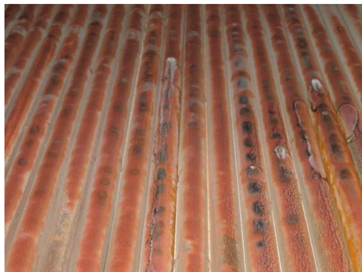
圖 16. 爐管過熱之表面缺陷，可不搭架執行檢測
