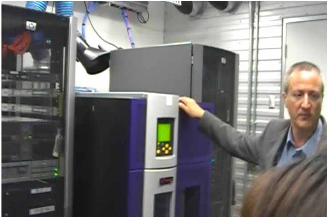
保存維護中心數位檔案儲存機組之 2
