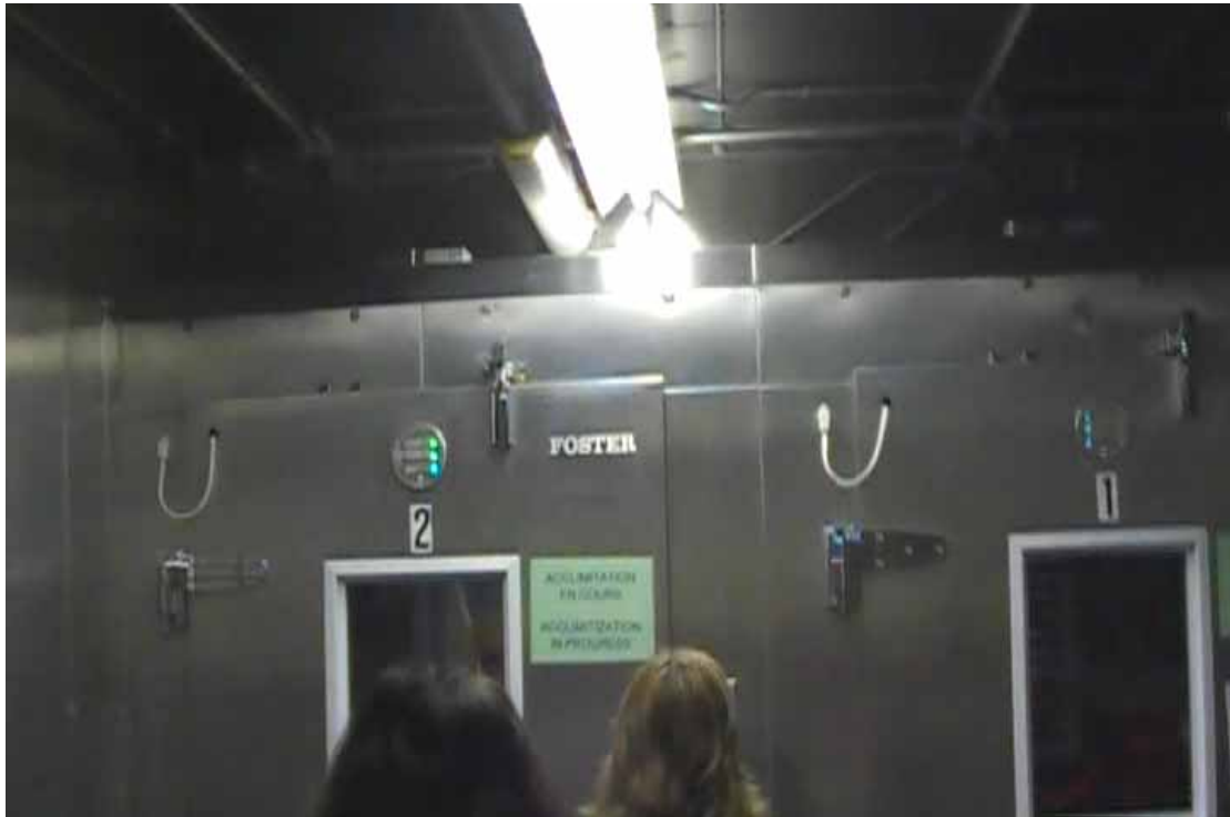
保存維護中心彩色底片類檔案冷凍庫房升降溫設備
