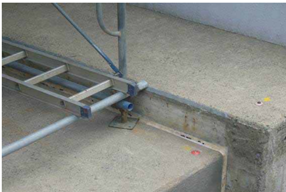
照片 2 2 號機主變壓器位置地層下陷情況
