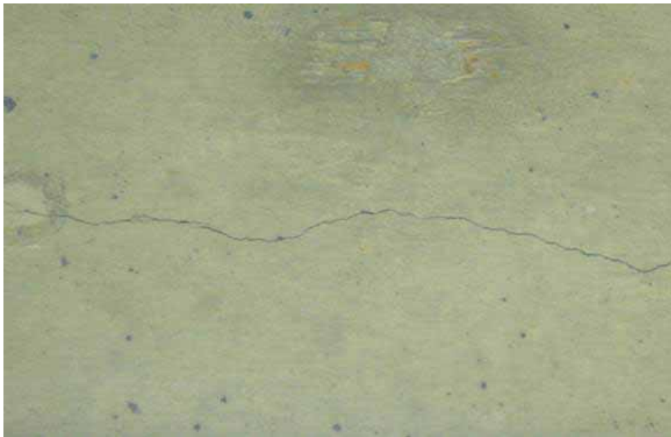
照片 4 原子爐廠房結構龜裂痕跡
