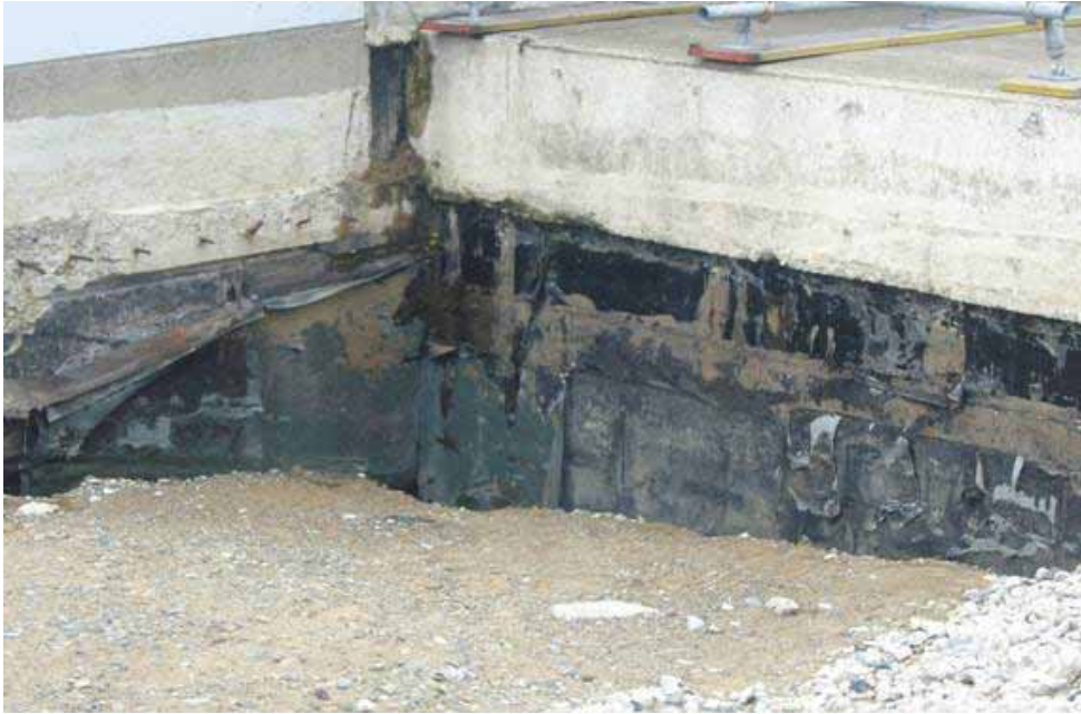
照片 7 輕油槽地層下陷
