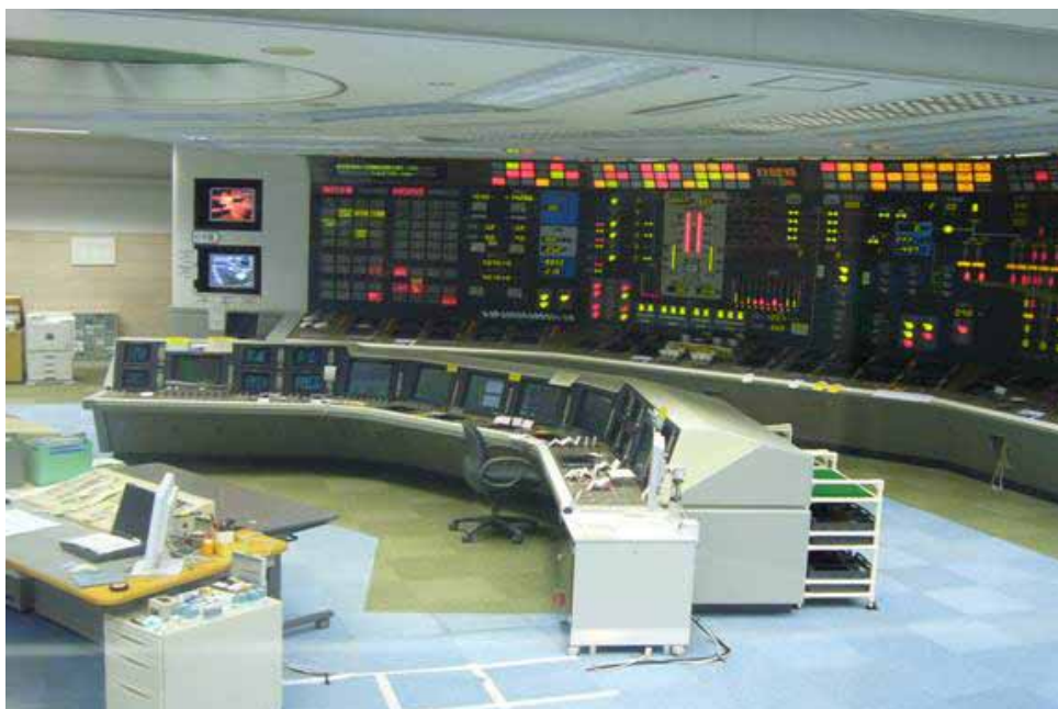
照片 5 6/7 號機控制室
