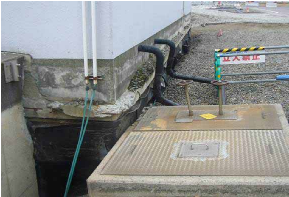
照片 8 輕油槽地層下陷
