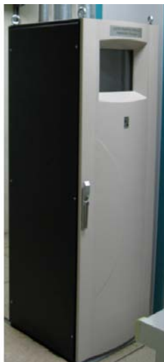
▲圖 13 核三廠飼水系統超音波流量計儀控盤
