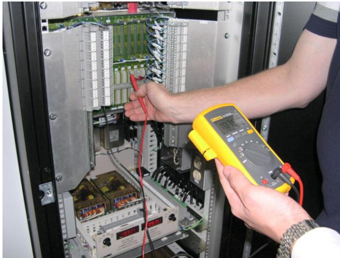
▲圖 15 在 UFM 電子儀控盤背面使用標準電壓表量測背盤 VME 模組接腳
