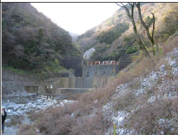
圖 2.3.4-5 二號壩頂加鋼管捕捉流木
