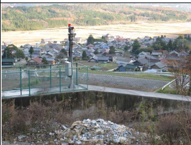
圖 2.3.4-7 沉砂池加警報器
