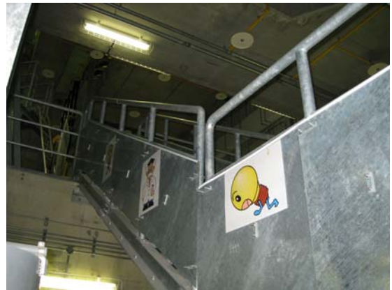
圖 3-26 照明及逃生標示
