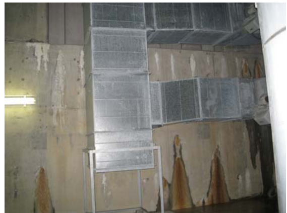
圖 3-24 洞道通風設備
