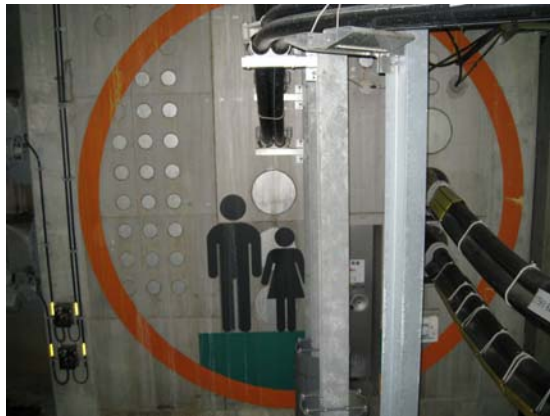
圖 3-25 洞道入口防水匣門
