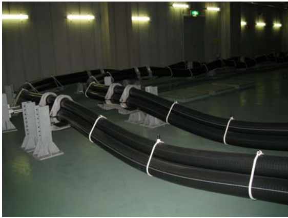
圖 3-20 電纜整理室內佈設情形
