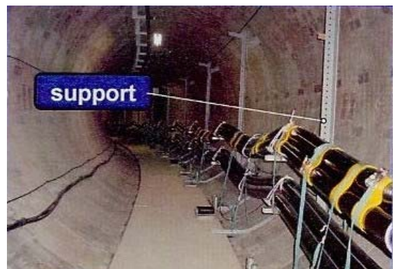
圖 3-12 洞道內電纜採品型蛇行佈設
