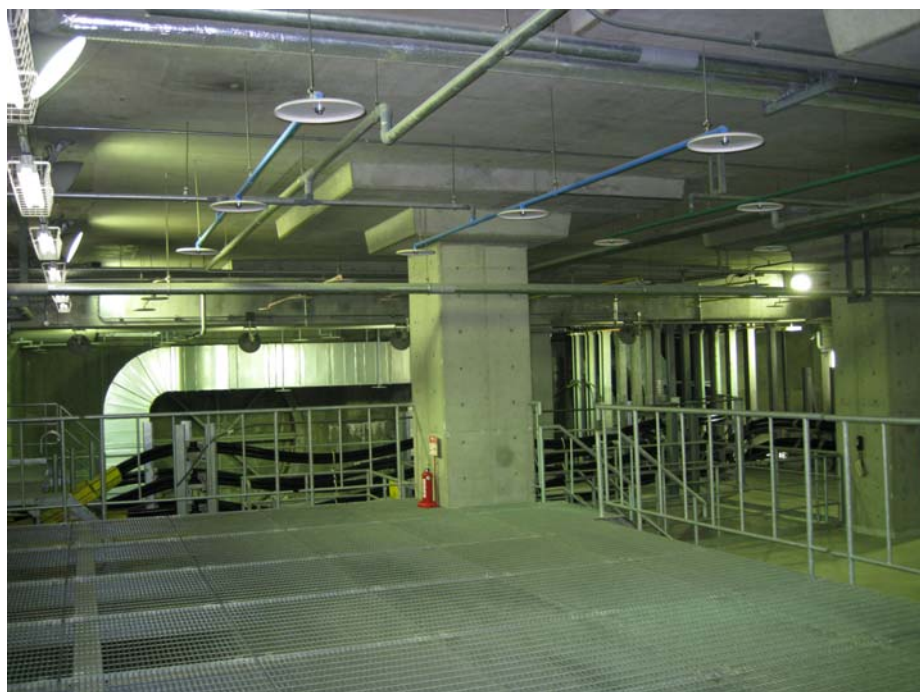
圖 4-9 變電所內角落地帶之照明、消防及通風等設備
