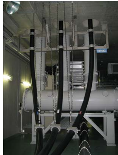
圖 3-21 電纜引入 GIS 室
