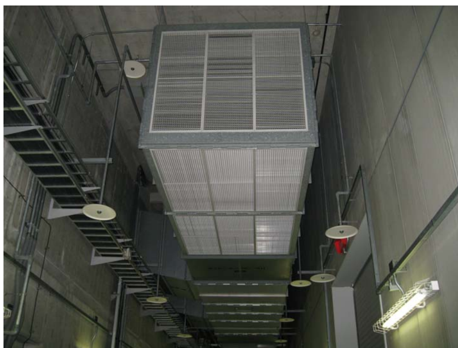
圖 4-8 變電所內之通風設備
