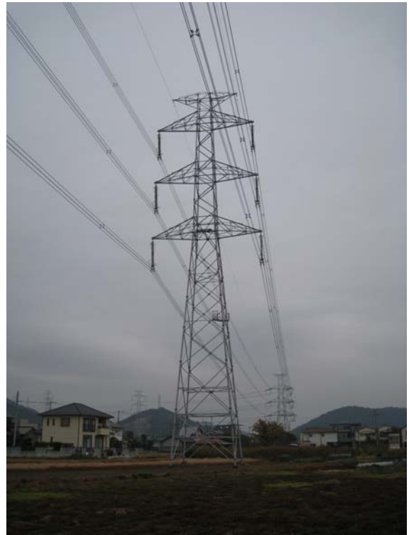
圖 4-17 275kV 四導體架空線
