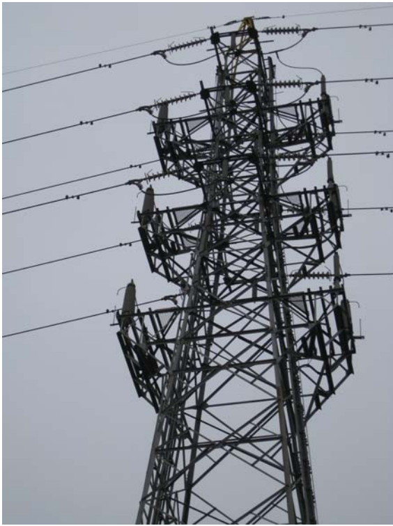
圖 4-16 77kV 級鐵塔連接站
