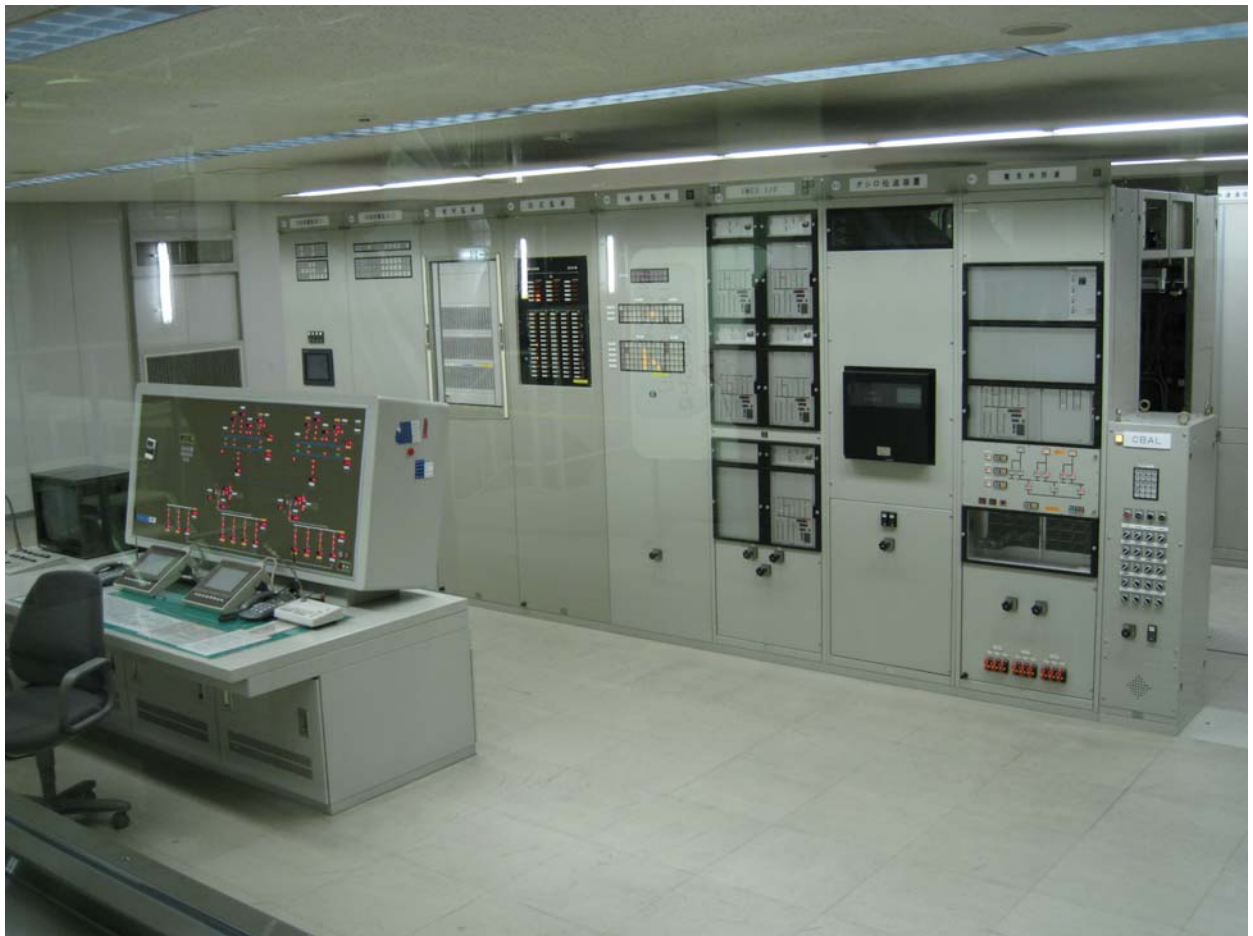
圖 3-34 名城變電所之控制室
